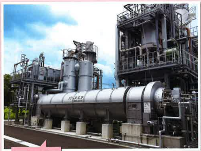
固形燃料化施設
